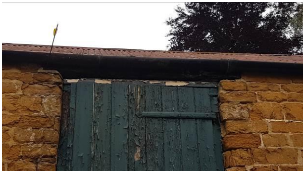
30. Gap above hayloft door
