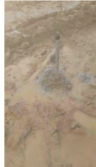
17.11.22 – Example vapour probe / diffusion tube installation (VP1)
